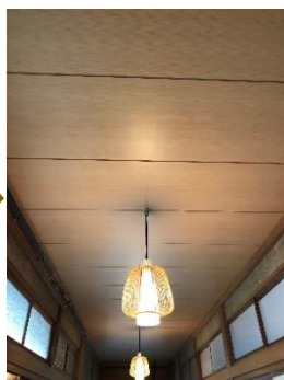
廊下天井の下地タルキにキクイムンが入っていたため、天井板を張り替えました。
